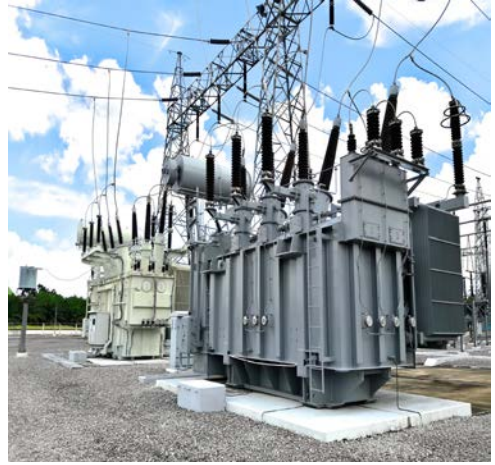
Görsel 3.60: Yüksek güçlü transformatörler
