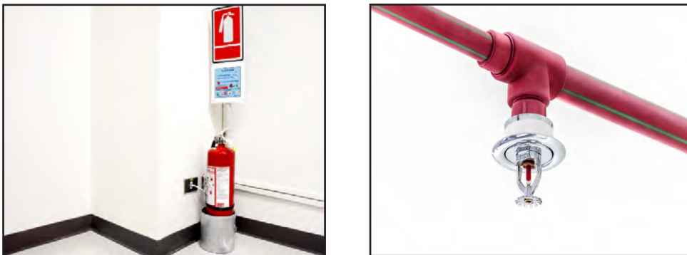
Görsel 5.22: Yangın tüpü ve depo yağmurlama sistemi
