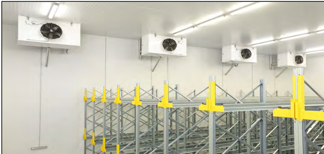
Görsel 3.14: Soğuk hava deposu
