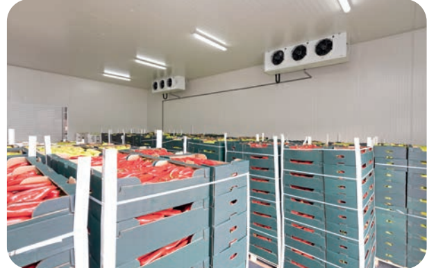
Görsel 2.19: Soğuk hava deposu
