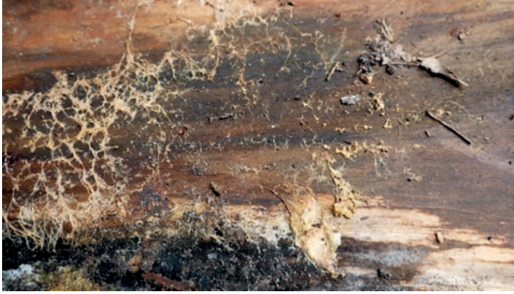
Görsel 1.24: Çürümüş ahşap örneği
