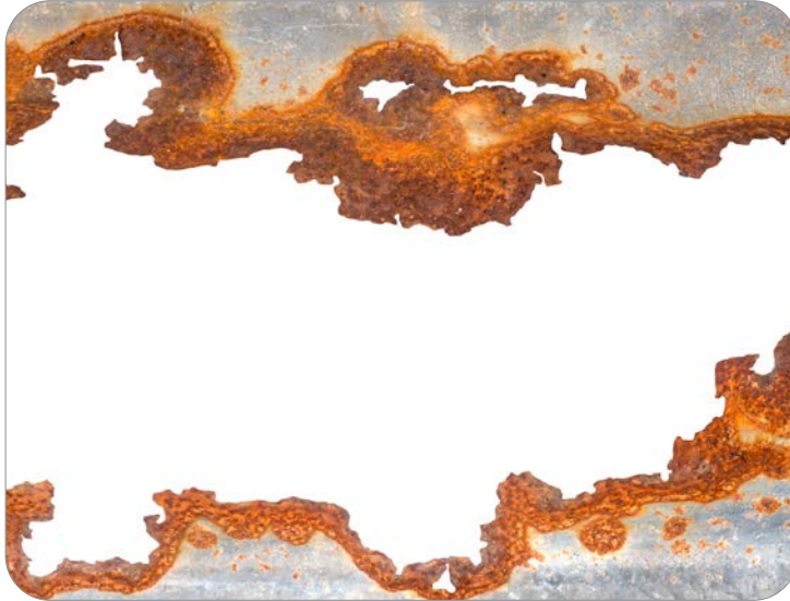
Görsel 2.3: Galvanik korozyon
