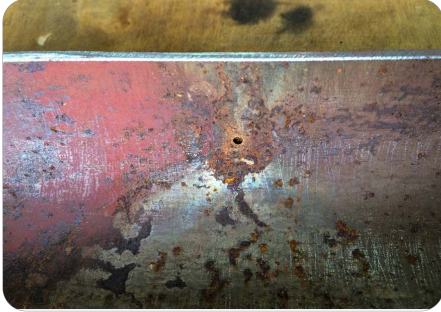
Görsel 2.4: Çukurcuk korozyon
