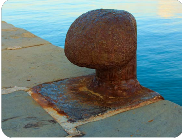
Görsel 2.2: İskele babası üzerindeki homojen korozyon
