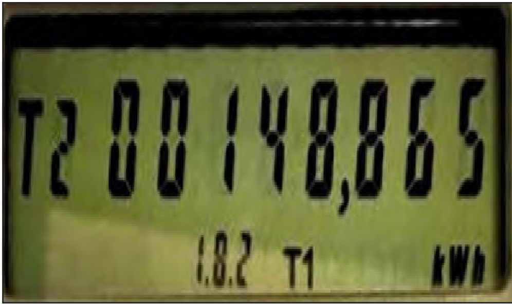
Görsel 2.22: Elektrik sayacı
