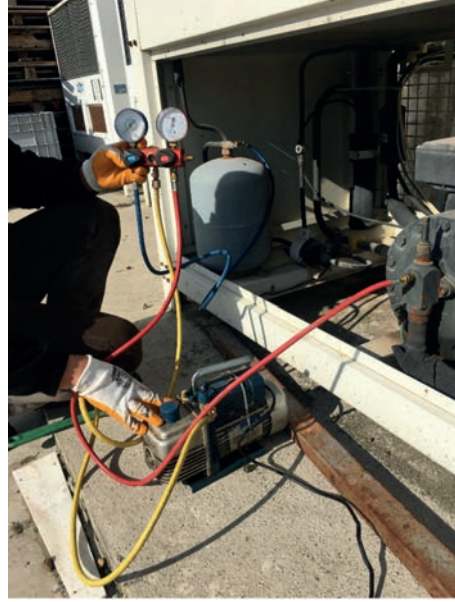
Görsel 5.9 Soğutma devresine çoklu vakumlama bağlantısı
