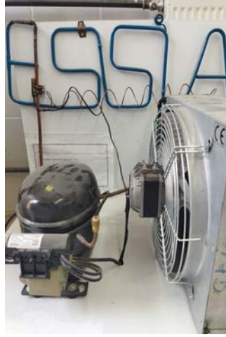
Görsel 4.9 Dış ünite soğutma devresi
