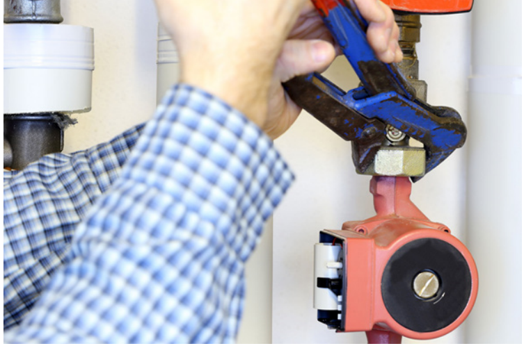
Görsel 10.10: Sirkülasyon pompasının tesisattaki yeri ve bağlantısı
