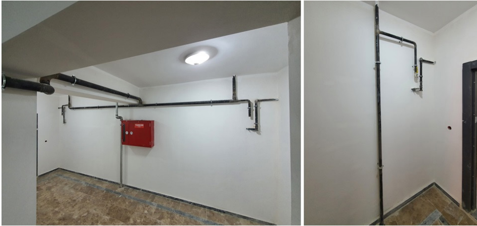
Görsel 3.12: Doğal gaz kolon tesisatı
