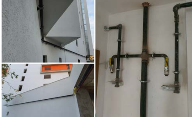
Görsel 3.15: Doğal gaz borularının kelepçeler ile yapı elemanlarına sabitlenmesi
