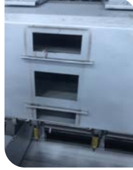
Görsel 6.34: b) Hava emiş kanalları kontrol pencereleri
