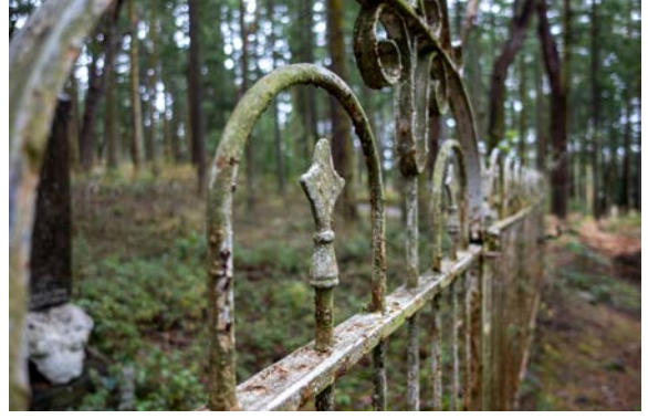
Görsel 1.58: Demirin paslanması (korozyon)
