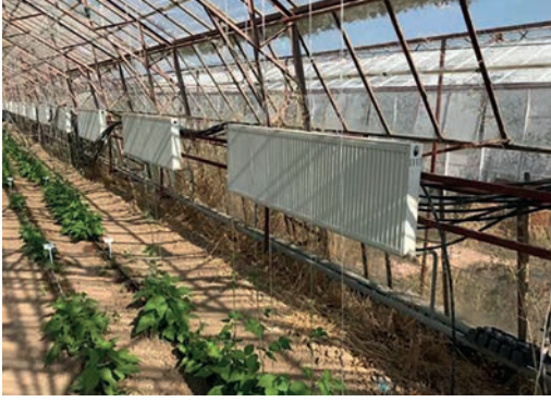
Görsel 2.65: Yan duvar petekli ısıtma sistemi
