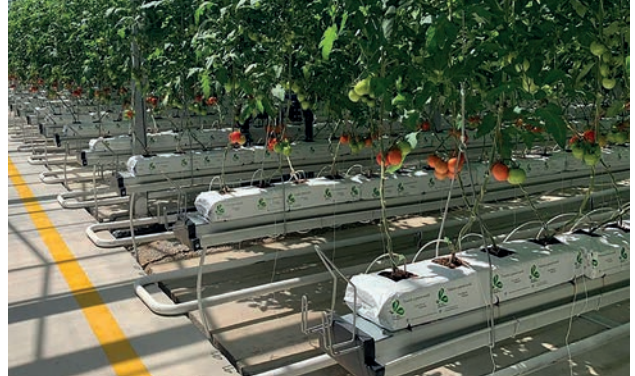
Görsel 2.68: Tezgâh altı borulu ısıtma sistemi
