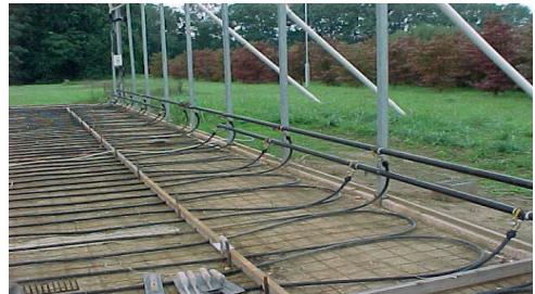
Görsel 2.61: Jeotermal kaynak ile sera toprağının ısıtılması
