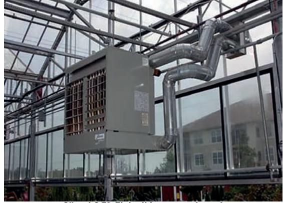
Görsel 2.71: Elektrikle ısıtma sistemi
