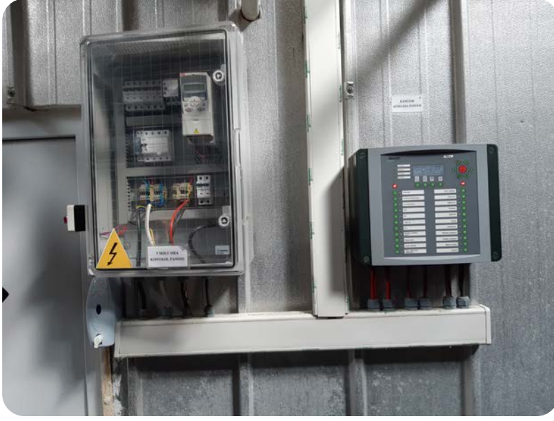
Görsel 1.43: Havalandırma takip panosu
