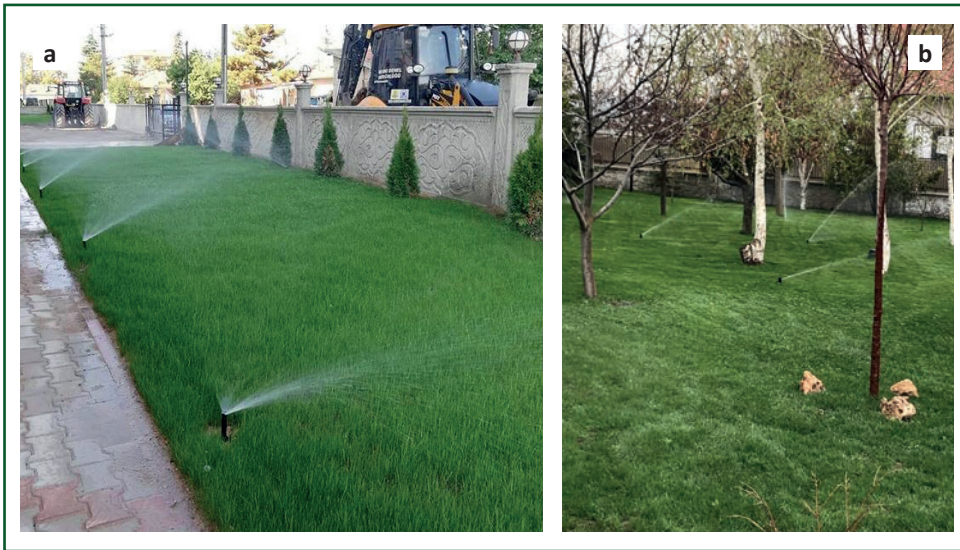
Görsel 3.12: Rulo çim uygulanmış alanda yağmurlama sulama sistemi
