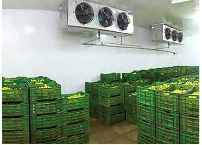
Görsel 1.103: Makineyle soğutulan depo
