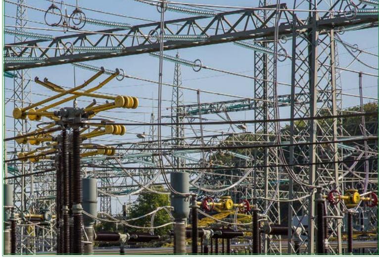
Görsel 4.9: Trafo merkezi
