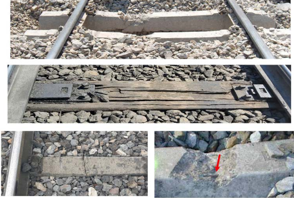
Görsel 3.45: Çeşitli travers arızaları
