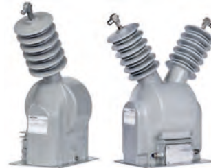
Görsel 3.53: Haricî tip gerilim transformatörleri
