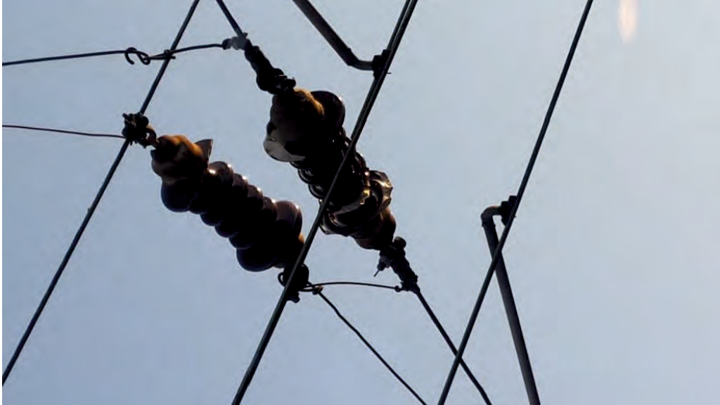
Görsel 4.18: Hasarlı izolatörler
