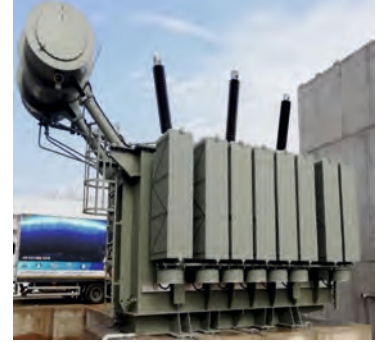
Görsel 3.20: OFAF soğutmalı transformatör
