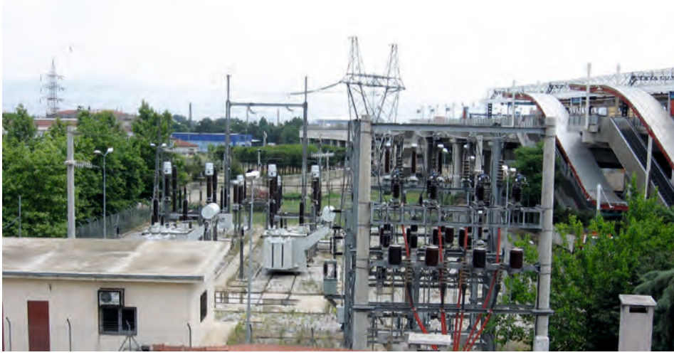
Görsel 2.11: YHT hattı trafo merkezi
