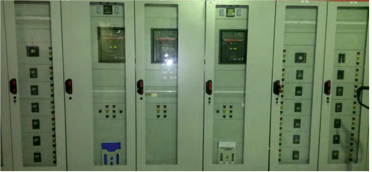
Görsel 3.167: İstasyon 4 (Boğaziçi Üniversitesi İstasyonu) ana dağıtım panoları
