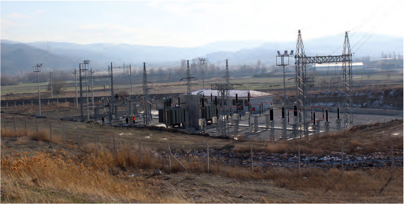
Görsel 3.137: TCDD demiryolu trafo merkezi
