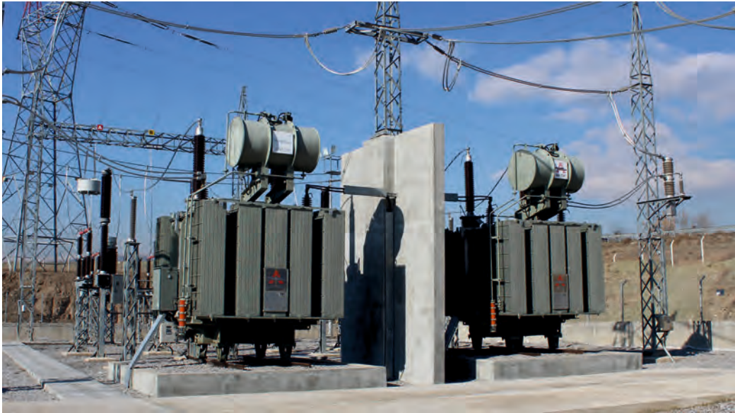
Görsel 3.146: Güç trafoları
