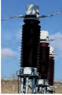
Görsel 3.33: YG akım transformatörü
