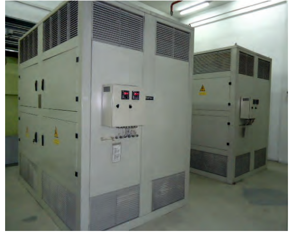
Görsel 3.163: Cer trafosu
