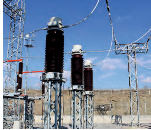
Görsel 3.140: Primer kısmı akım trafosu
