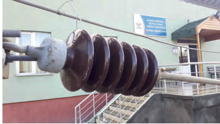
Görsel 4.47: İzolatörlerin bakımı
