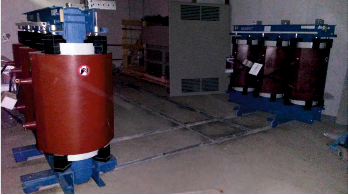
Görsel 3.169: Etiler İstasyonu 34,5 / 0,4 kV 1000 kVA kuru tip iç ihtiyaç trafoları
