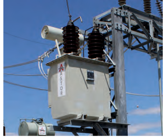
Görsel 3.154: Yardımcı servis trafosu
