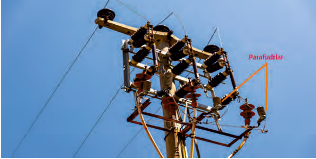
Görsel 3.115: Yer altı kablosunun havai hatta bağlantısında parafudr kullanımı
