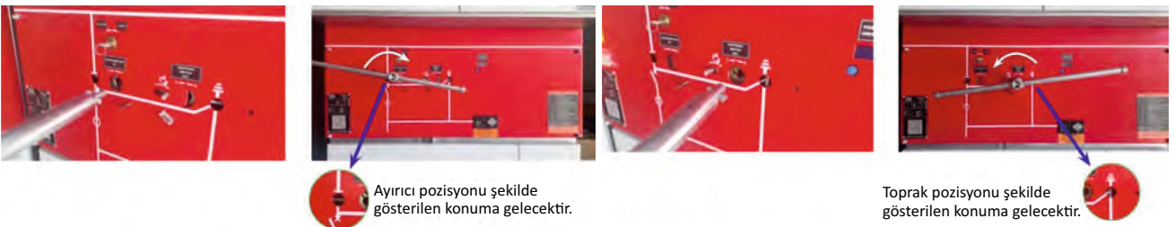
Görsel 3.97: Ayırıcının açılması
