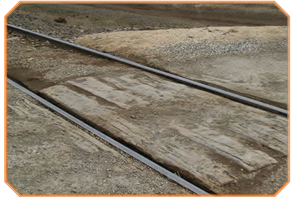
Görsel 4.7: Ahşap travers kaplamalı hemzemin geçit
