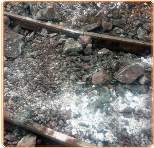
Görsel 5.16: Taş düşmesinden kaynaklı üstyapıda görülen deformasyonlar
