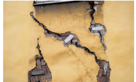
Görsel 3.69: Onarım için duvar çatlaklarının işaretlenmesi
