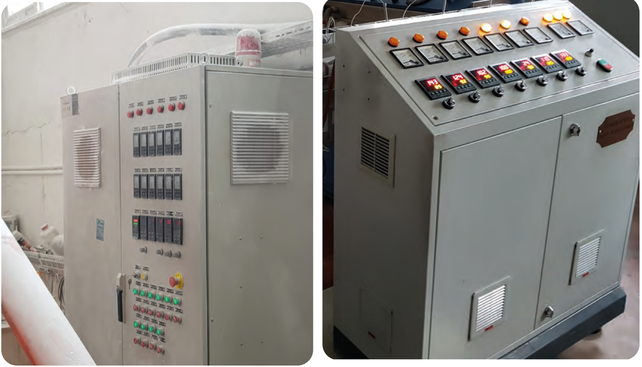
Görsel 7.15: Plastik geri dönüşüm hattı kontrol ve sıcaklık ayar panosu
