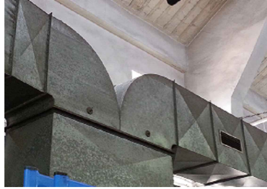
Görsel 4.1: Havalandırma sistemleri
