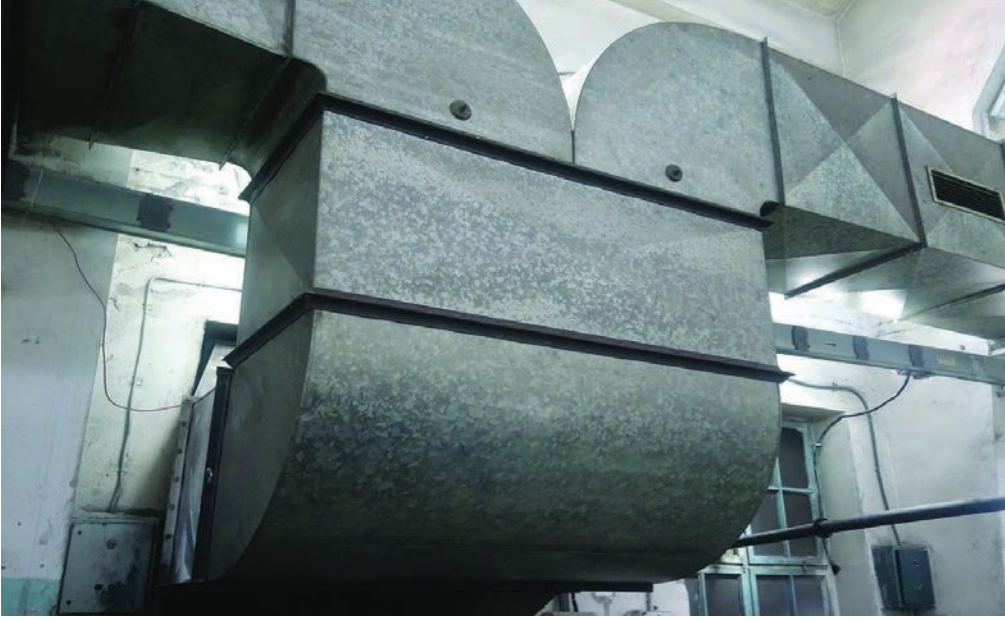
Görsel 7.1: Havalandırma sistemi
