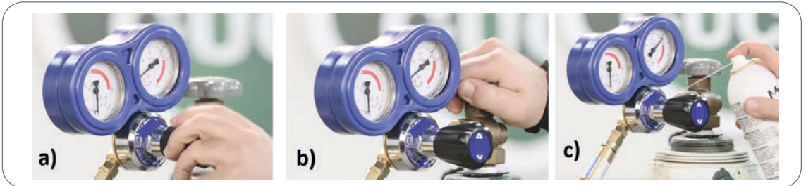
Görsel 7.3: Tüp ve regülatör kısmının gaz kontrolü
