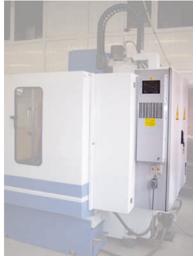
Görsel 1.43: CNC freze tezgâhı elektrik panosu
