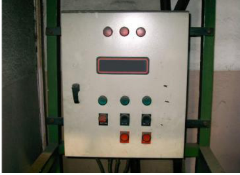
Görsel 8.3: Dağıtım panosu
