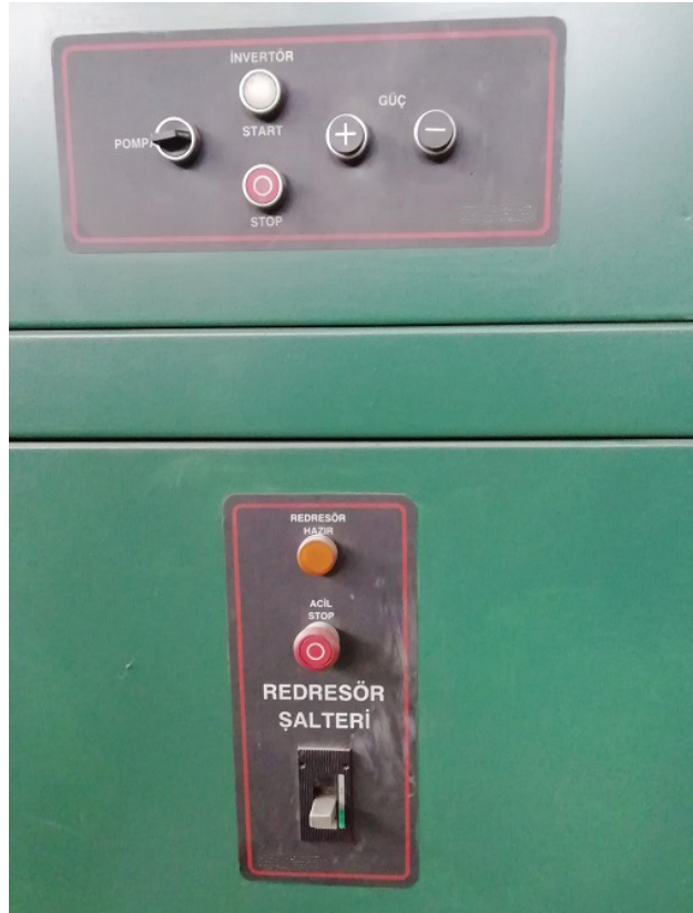
Görsel 8.5: Invertör start-stop düğmesi
