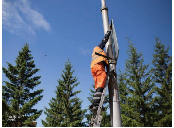
Görsel 4.66: Elektrik direği üstü blackout montajı (Elektrik çarpması)
