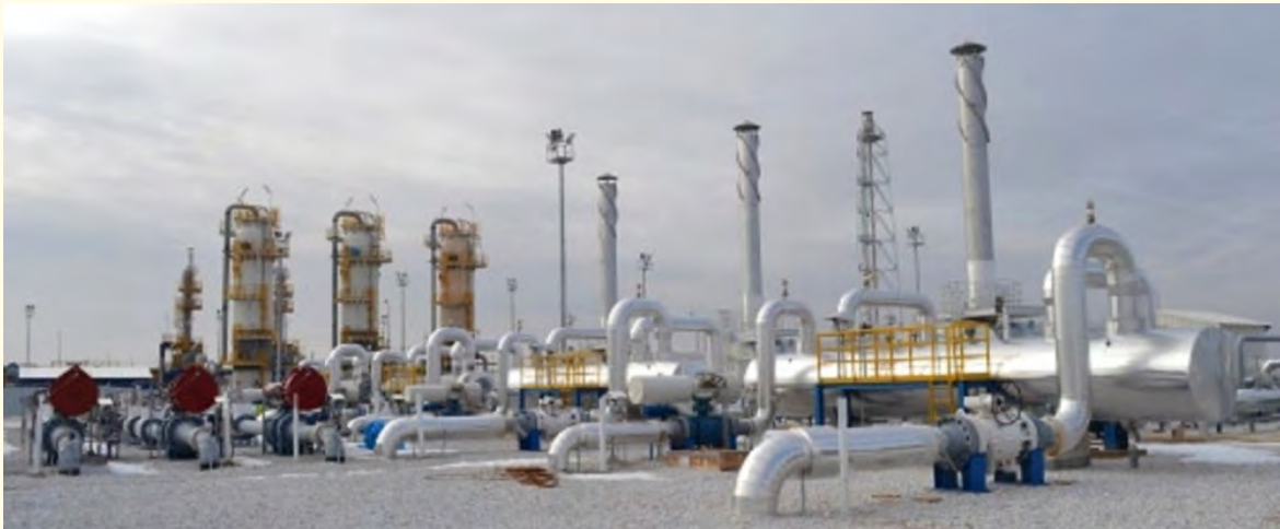
Görsel 7.12: Doğal gaz depolama tesisi
