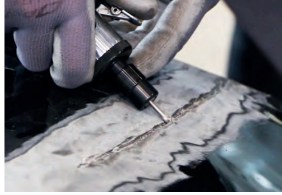
Görsel 3.41: Hasarlı kısma oluk açılması
