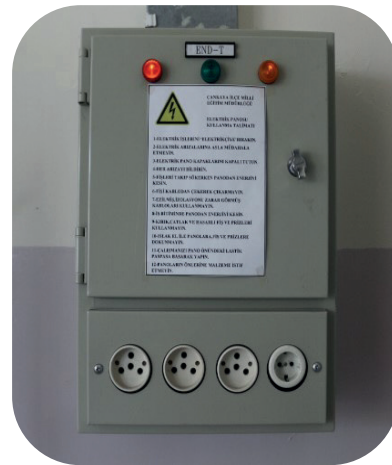
Görsel 1.15: Elektrik panosu
