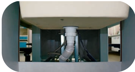
Görsel 1.14: Atık su tesisatı
