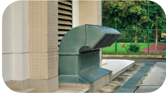
Görsel 1.18: Havalandırma sistemi
