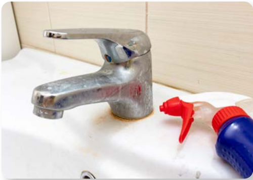
Görsel 7.1.6: Muslukta sert sular sebebiyle oluşan kireç
