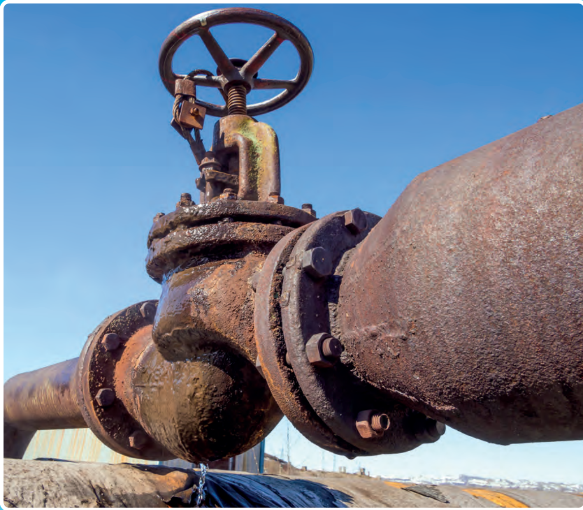
Petrol boru hattındaki korozyon
