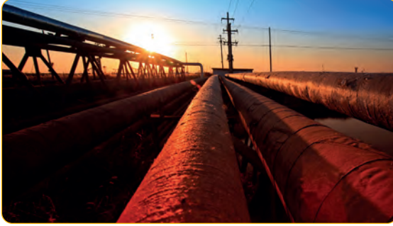
Görsel 2.3: Boru hattı
