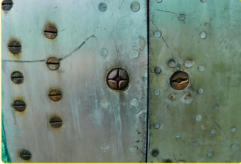
Görsel 1.9: Hatalı malzeme seçimi nedeniyle oluşan korozyon
