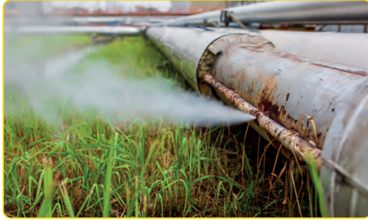
Görsel 1.10: Korozyon sonucu boru hattında oluşan gaz kaçağı
