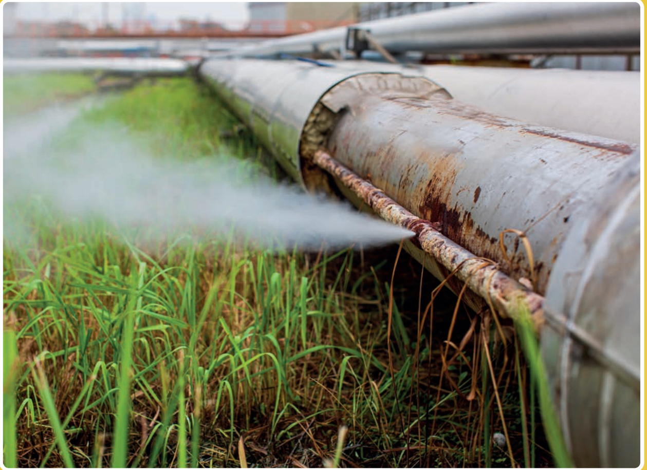
Görsel 9.2: Korozyon nedeniyle buhar sızıntısı
