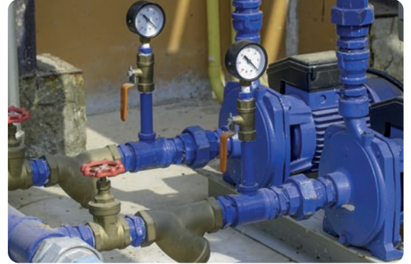
Görsel 2.12: Pompanın bulunduğu noktadan ana vana bağlantısı
