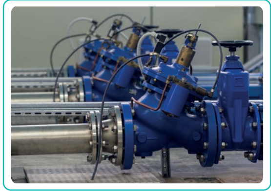
Görsel 2.11: Pompa ve çevre donanımı
