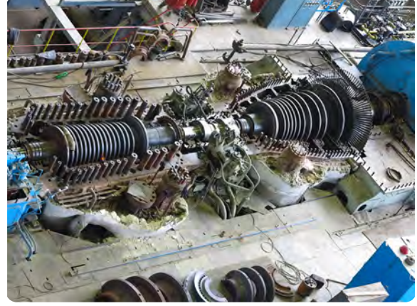
Görsel 9.14: Bakımdaki buhar türbini
