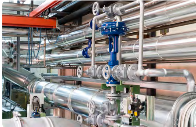
Görsel 7.6: Fırın sıcaklık kontrolü
