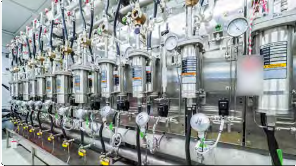
Görsel 8.3: Su kontrol sistemi
