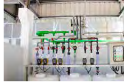
Görsel 6.6: Soğutma kulesi için kimyasal dozaj istasyonu
