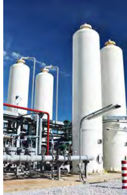
Görsel 4.4: Endüstriyel nitrojen tankları
