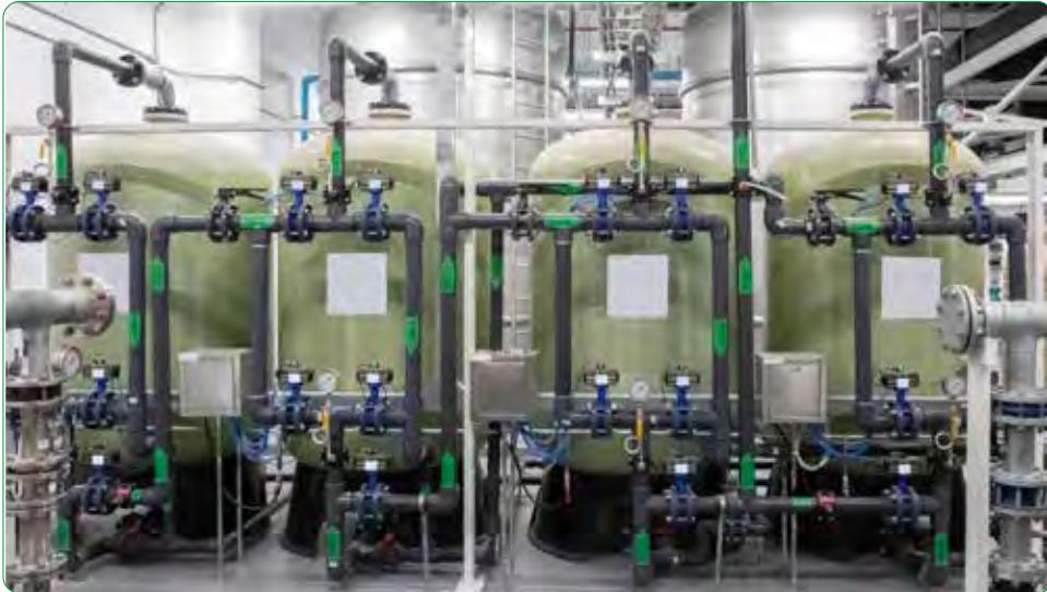
Görsel 7.9: Su yumuşatma kontrolü
