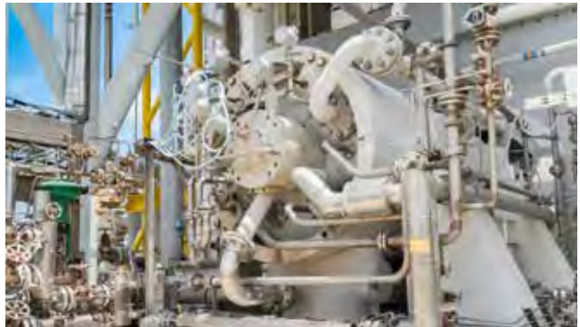
Görsel 5.2: Gaz kompresörü
