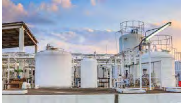
Görsel 4.3: Azot gazı tesisi
