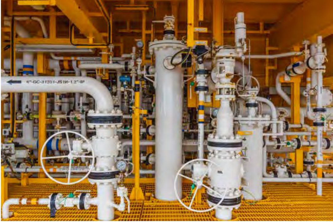
Görsel 5.3: Knock-out dramı, valf ve proses boru hattı
