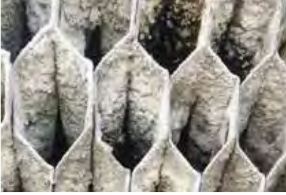
Görsel 6.4: Soğutma kulesinde kazan taşı
