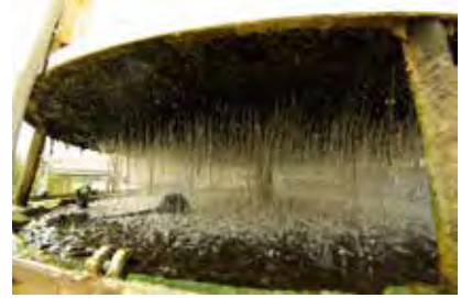
Görsel 6.2: Soğutma kulesinin içi
