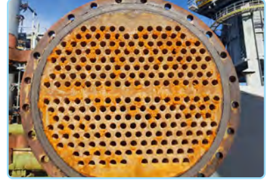
Görsel 3.3: Korozyona uğramış buhar kazanı kızdırıcısı
