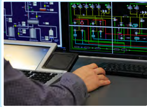
Görsel 1.37: SCADA kontrol merkezi
