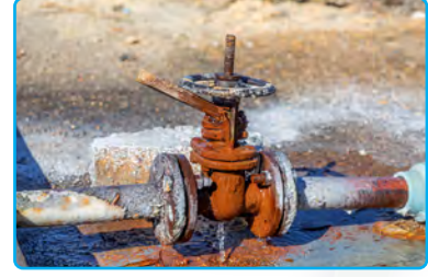
Görsel 2.5: Korozyon nedeniyle sızıntı yapan valf
