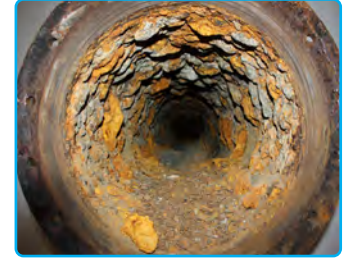
Görsel 3.16: Erozyon korozyonuna uğramış metal boru
