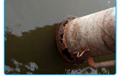
Görsel 2.23: Paslı su pompası borusu
