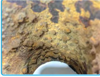
Görsel 1.22: Metal boru içerisinde erozyon korozyonu
