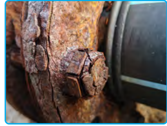
Görsel 1.26: Atmosferik korozyon örneği
