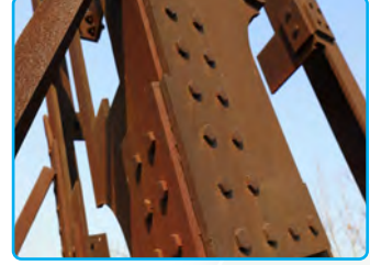
Görsel 1.17: Genel korozyona uğramış metal yapı
