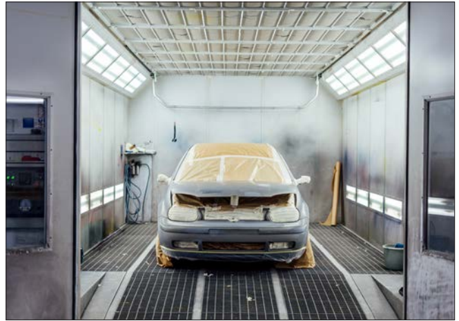
Görsel 1.31: Havalandırma sistemli boya uygulama kabini
