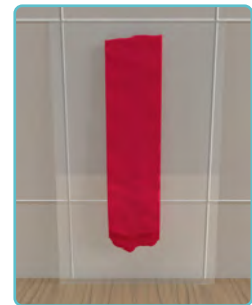
Görsel 2.43: Boyanın panel üzerinde akması
