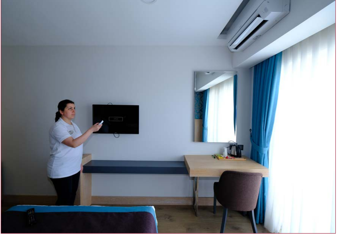
Görsel 2.19: Konuk odasındaki havalandırma ünitesinin kontrolü
