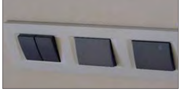
Görsel 4.11: Elektrik düğmesi ve prizler
