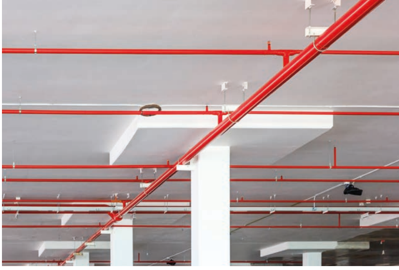
Görsel 5.13: Sprinkler sistemi
