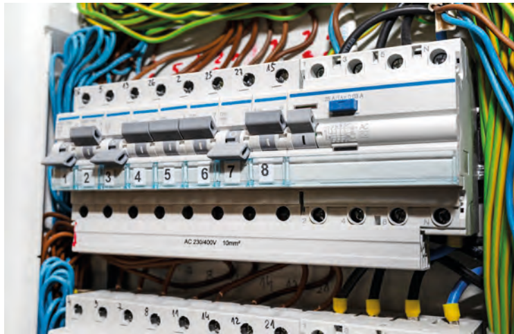
Görsel 8.10: Elektrik devre kesiciler
