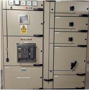
Görsel 3.47: Elektrik dağıtım panosu
