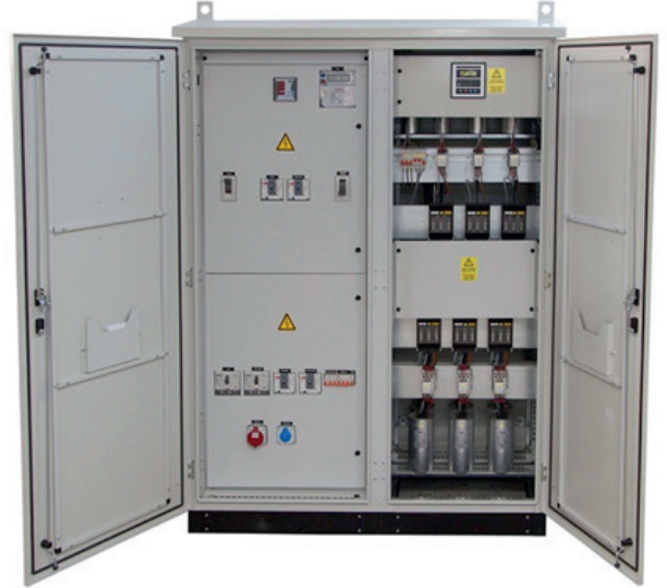
Görsel 3.44: Elektrik panosu
