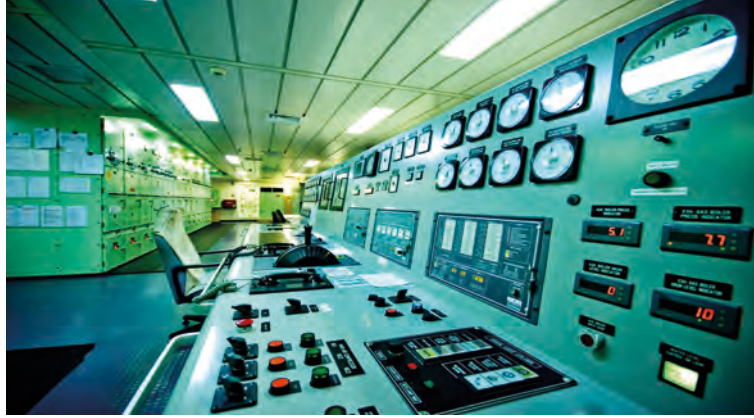
Görsel 8.59: Konteyner geminin motor kontrol odası
