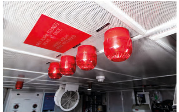
Görsel 8.60: Gemi makine dairesi yangın alarmları
