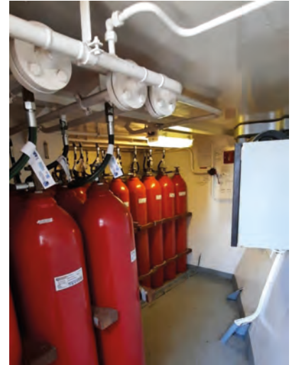
Görsel 8.64: Sabit karbondioksit söndürme tüpleri
