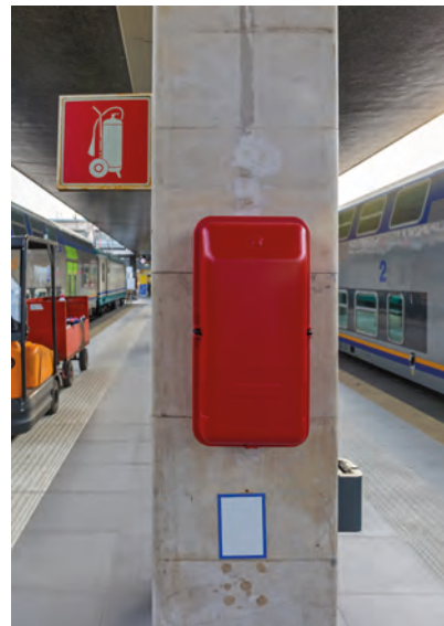
Görsel 8.29: Yangın söndürme tüpü
