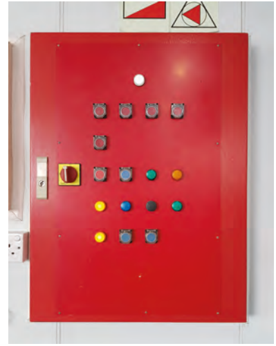
Görsel 8.61: Yangın söndürme sistemi ana kontrol paneli
