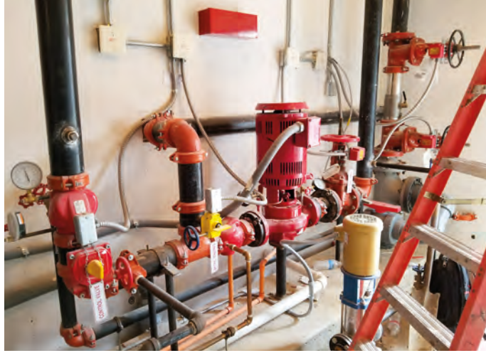
Görsel 8.63: Sprinkler sistem mekanik kontrol odası
