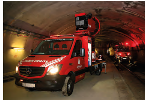
Görsel 3.46: Mekanik havalandırma
