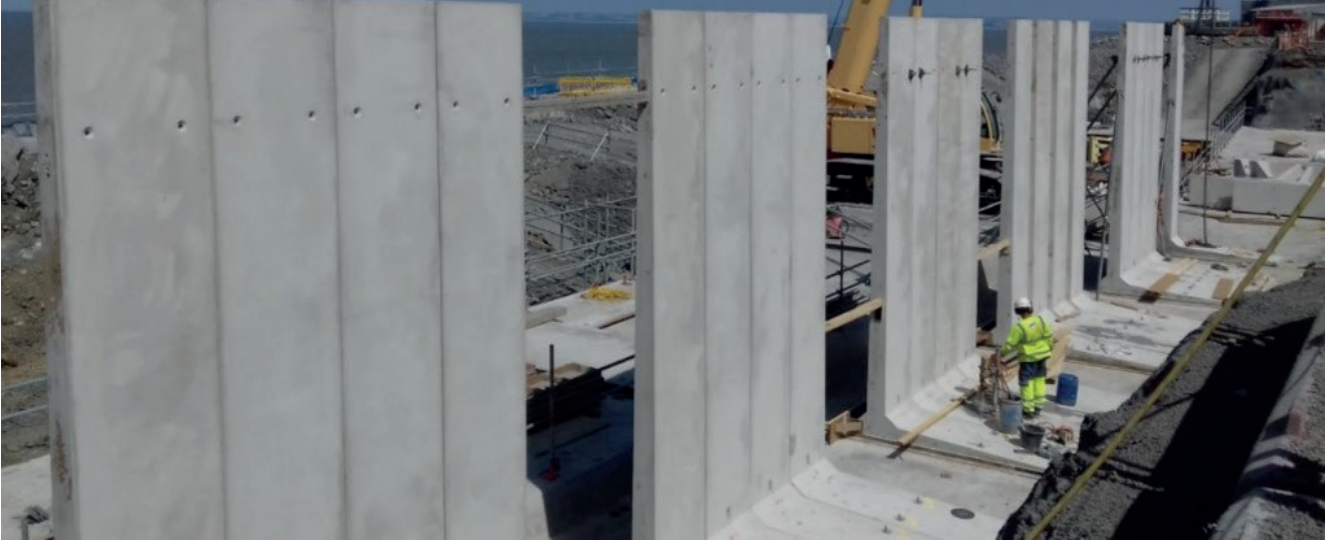
Resim 1.21: Prefabrik istinad duvarı
