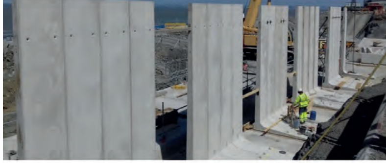
Resim 1.23: Prefabrik istinad duvarı
