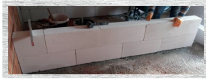
Resim 19.13: Bloklarda derz kaydırılması
