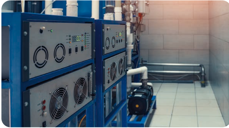
Görsel 1.34: İçme suyu fabrikasında kullanılan ozon jeneratörü
