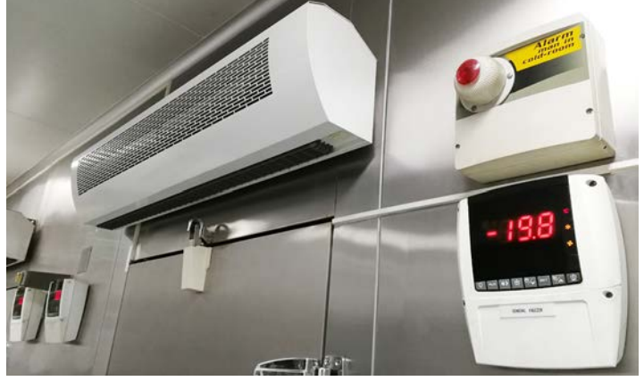
Görsel 1.27: Soğuk depo kontrol sistemleri
