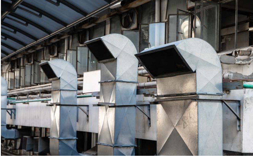
Görsel 1.25: Havalandırma sistemleri
