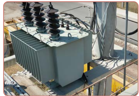
Görsel 1.1: Direk tipi trafo merkezi
