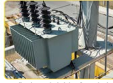
Görsel 1.1: Direk tipi trafo merkezi
