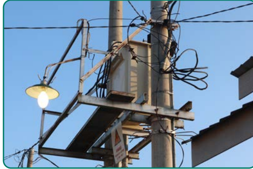
Görsel 5.16: Orta gerilim beton trafo direği
