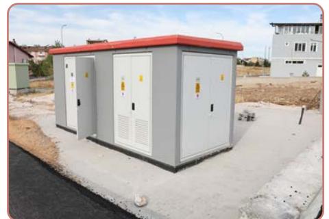
Görsel 1.3: Bina tipi trafo merkezi
