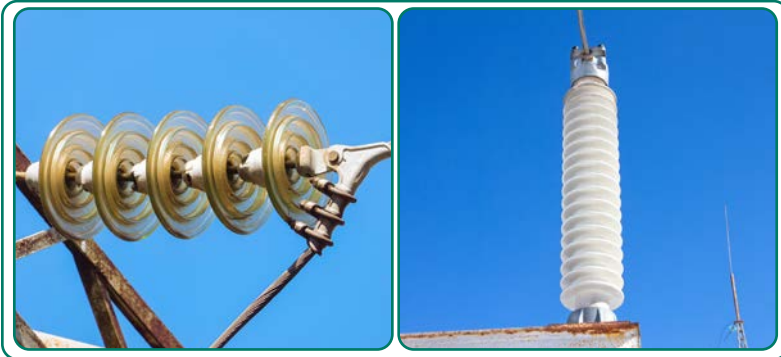
Görsel 5.37: Mesnet izolatörler
