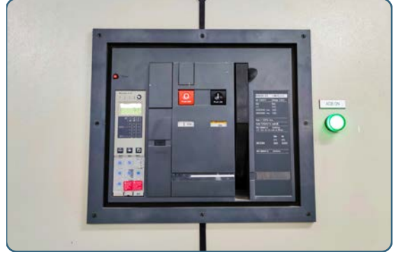
Görsel 3.12: Kesici açma ve kapama kontrol ünitesi
