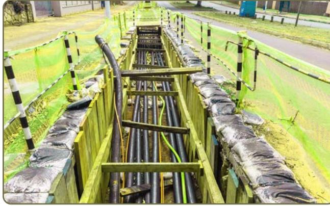
Görsel 6.1: Yer altı kabloları
