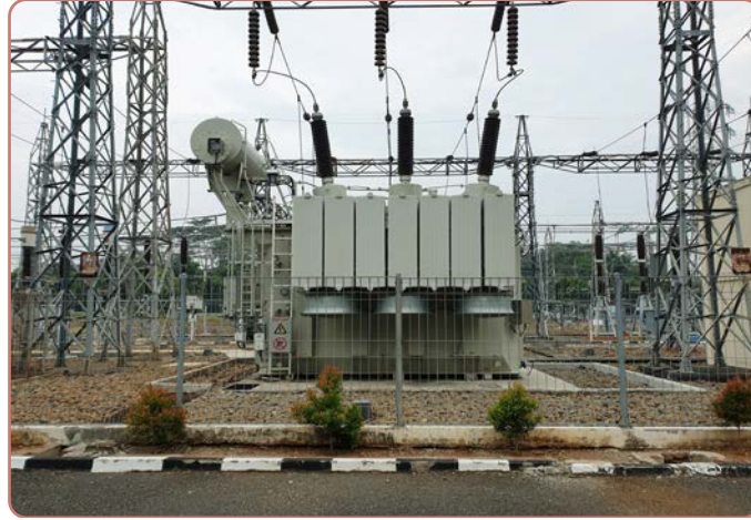
Görsel 1.2: Açık yer tipi trafo merkezi
