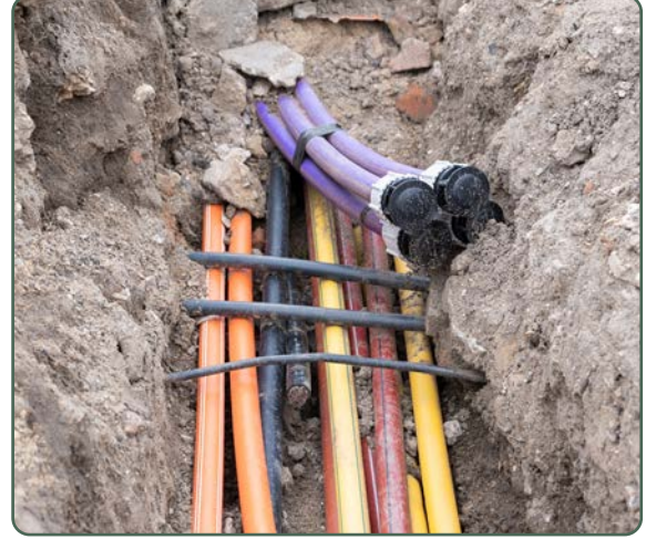
Görsel 6.2: Yer altı kablosu
