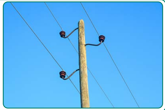
Görsel 5.20: Demir travers
