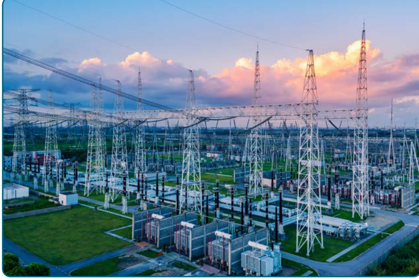
Görsel 7.1: Yüksek gerilim tesisi
