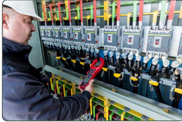
Görsel 4.5: Termik manyetik şalterlerin pano içerisindeki bağlantıları
