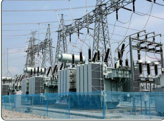
Görsel 4.7: Şalt sahası
