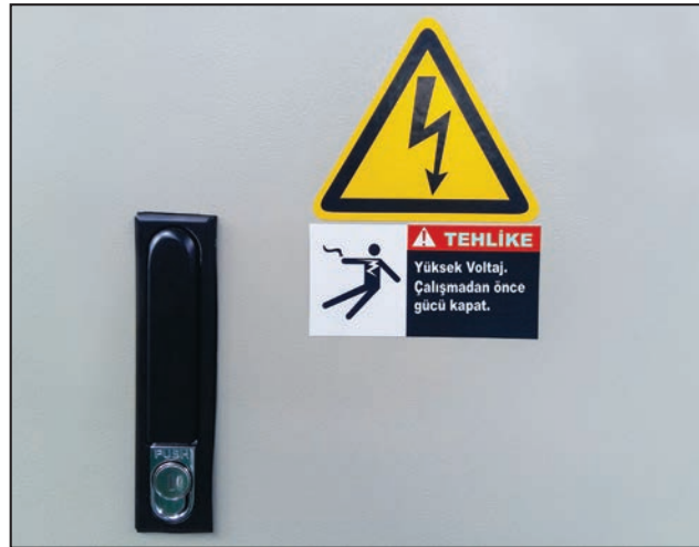
Görsel 1.1: Elektrik panosu uyarı levhası
