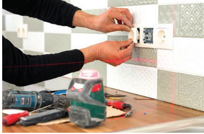
Görsel 2.40: Sıva altı tesisat
