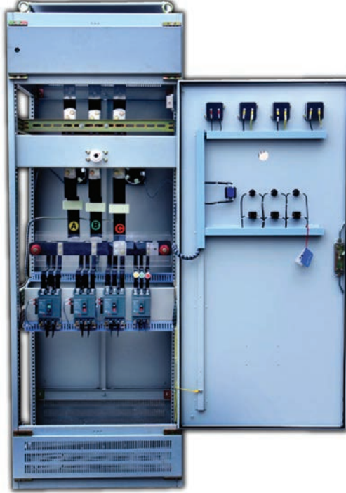
Görsel 6.23: Ana dağıtım panosu
