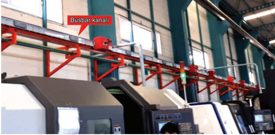
Görsel 3.4: Busbar kanalları
