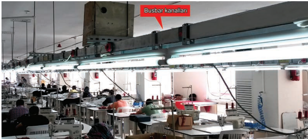
Görsel 3.5: Bir atölyenin busbar sistemi
